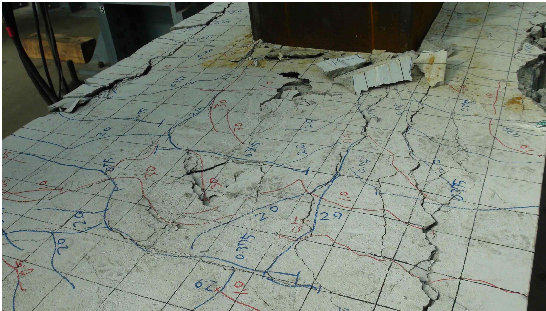
(d) 상부 슬래브 균열
