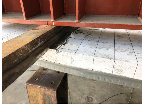
(b) 좌측 가력점 슬래브 정면 균열
