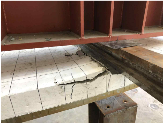
(c) 좌측 가력점 슬래브 후면 균열
