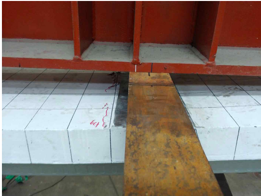
(c) 우측 가력점 슬래브 후면 균열
