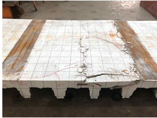
(d) 중앙부 콘크리트 슬래브 균열
