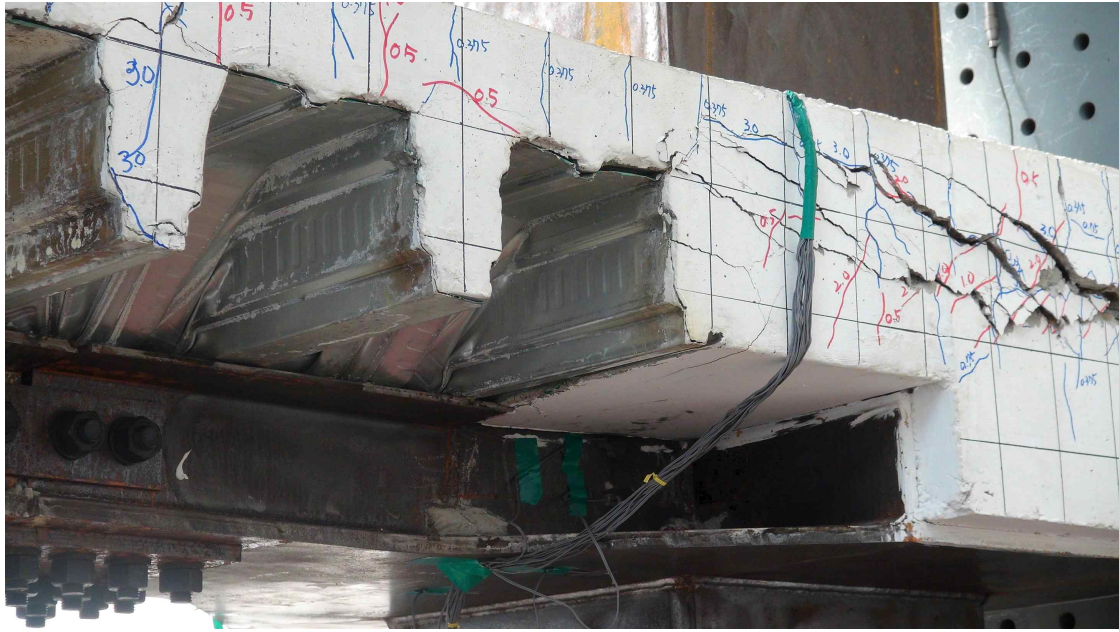
(c) 후면 슬래브 균열
