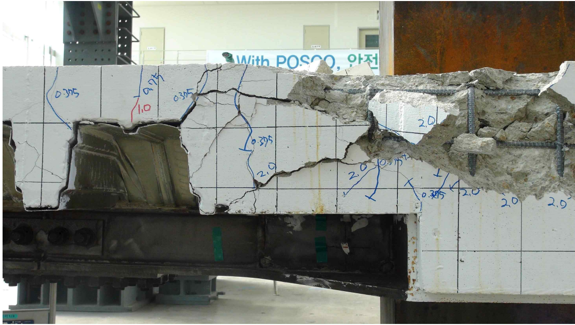
(c) 후면 슬래브 균열
